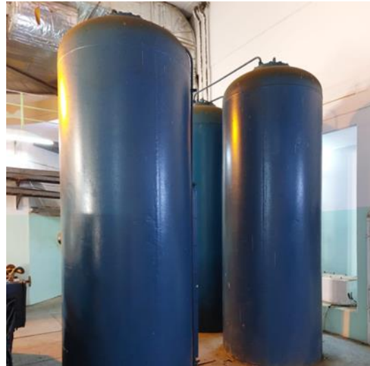
(d) The sump Tank
